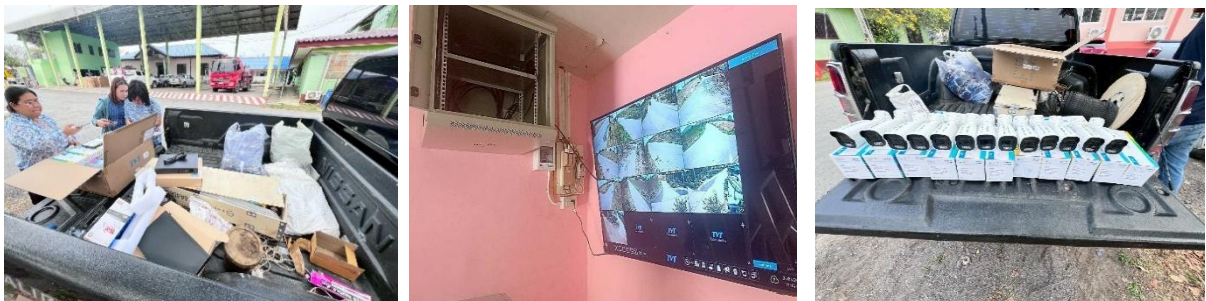
19. โครงการติดตั้งกล้องวงจรปิด (CCTV) หมู่ที่ 5 งบประมาณตั้งไว้ 497,000 บาท เบิกจ่าย 496,000 บาท
