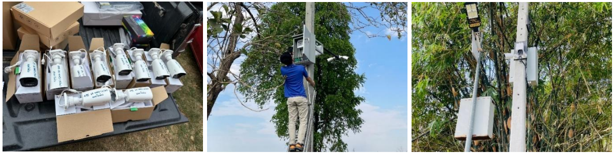
18. โครงการติดตั้งกล้องวงจรปิด (CCTV) หมู่ที่ 4 งบประมาณตั้งไว้ 499,000 บาท เบิกจ่าย 498,000 บาท
